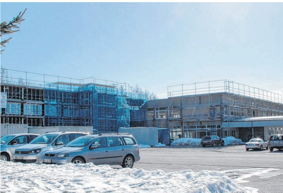
Es wird kräftig gebaut, damit die neuen Fünftklässler beste Bedingungen vorfinden: Neben Simmerath ist nun auch der Standort Hürtgenwald für die Sekundarschule gesichert.
